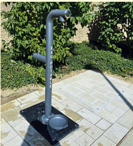
Drénkwaasserspender / Fontaine à eau potable - Park Léonie Koullen
